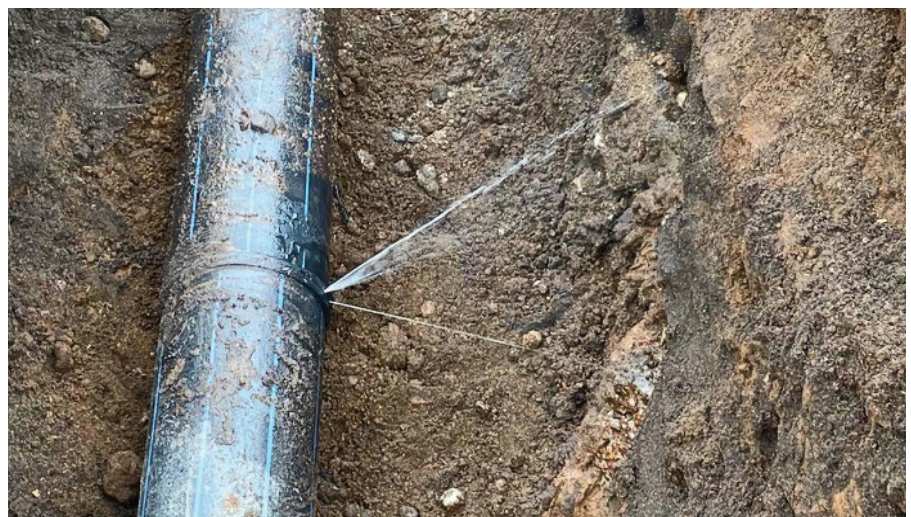
Fuga de água na tubagem de impulsão de água dessalinizada
