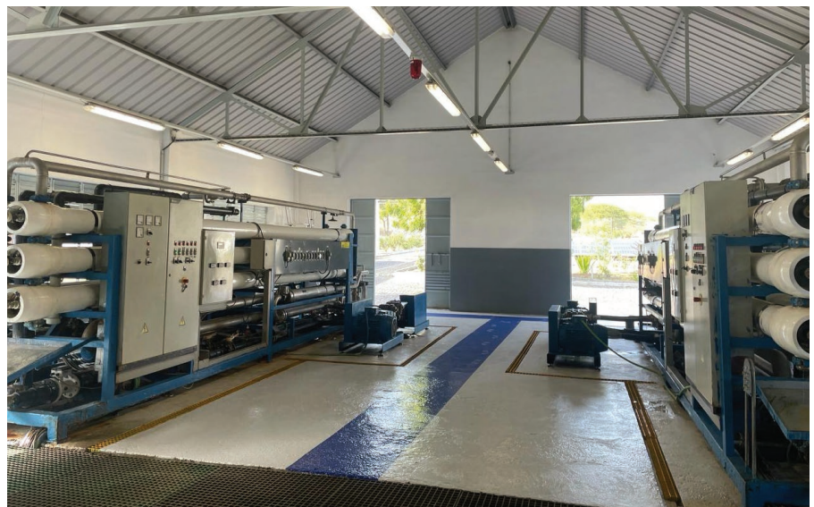
Sala de unidades dessalinizadoras da IDAM do Porto Novo
